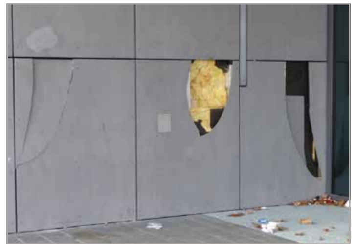
...Zerstörungen im Eingangsbereich der neuen Aula des Lessinggymnasiums (wurden inzwischen behoben)
