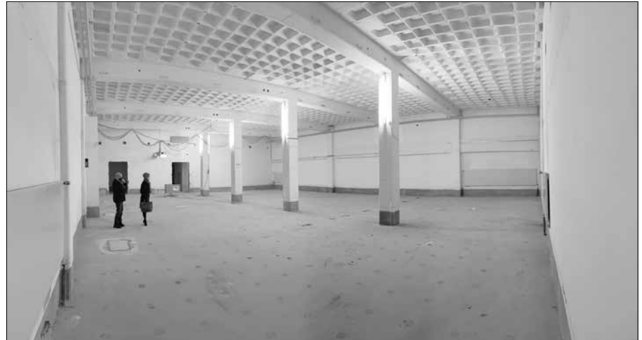
Zum Vergleich: die alte Serverhalle vor dem Umbau
