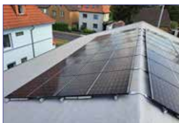
PV-Fläche auf dem Hallendach
