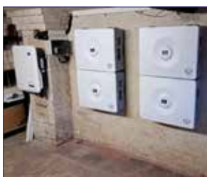
Batteriespeicher im Keller
